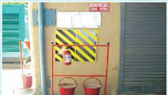
Fire-Fighting Equipment ਅਗਨਿਸਮਨ ਸਮੱਗਰੀ
