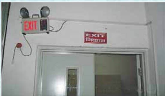
Emergency Light/ Exit Opening Outwards ਇਮਰਜੈਂਸੀ ਲਾਇਟ/ਬਾਹਰ ਨਿਕਲਾਂ ਬਾਹਰ
